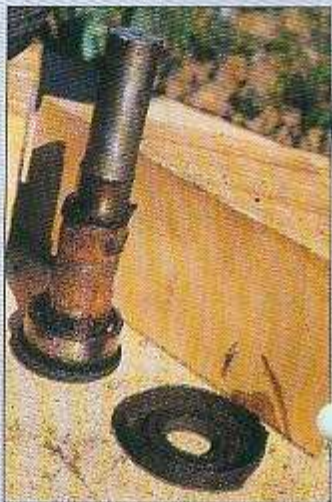
So fällt das eine Lager mitsamt der Buchse schließlich unten heraus. Die Nabe war dabei auf Kanthölzer gestützt
